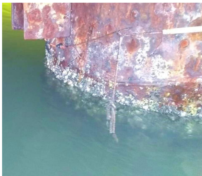
Figura 7 Detalhe do cabo de sustentação das placas cortado no ponto P-03 no canal do Porto de Santos, SP.
