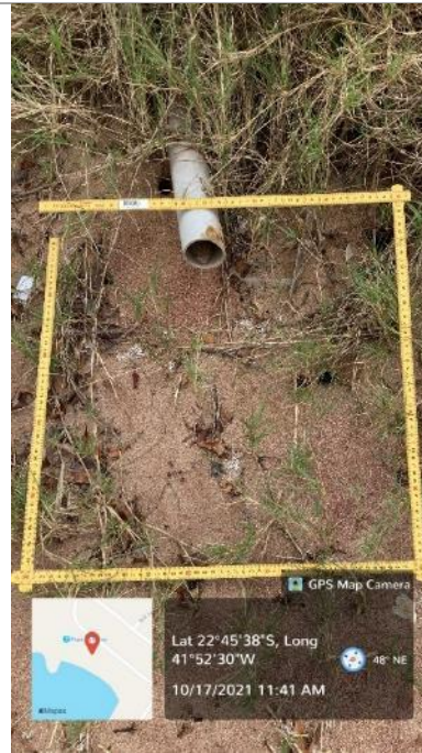
Figura 170: Cano de escoamento pluvial
